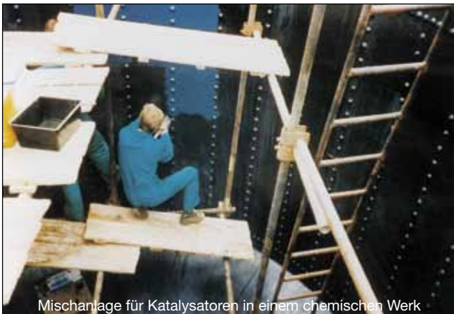
Mischanlage für Katalysatoren in einem chemischen Werk
